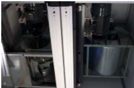
Stacked Fan Section
